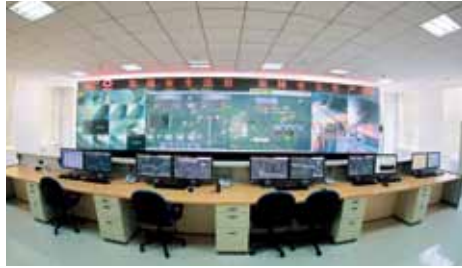
无人值守水泥生产线中控室
